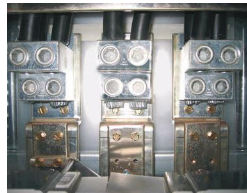
Conexión a bus de cobre utilizando tablillas mecánicas para circuitos en paralelo
