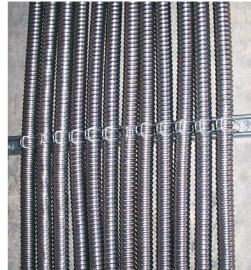
Instalaciones de cable tipo MC con soporte unicanal: En interior
