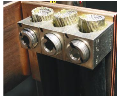
Conexión a bus de cobre con zapatas bimetálicas mecánicas
