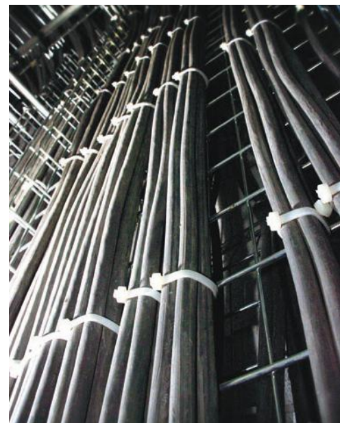
Instalación de cable monopolar tipo XHHW-2 LS en charola tipo malla: Arreglo Trébol
